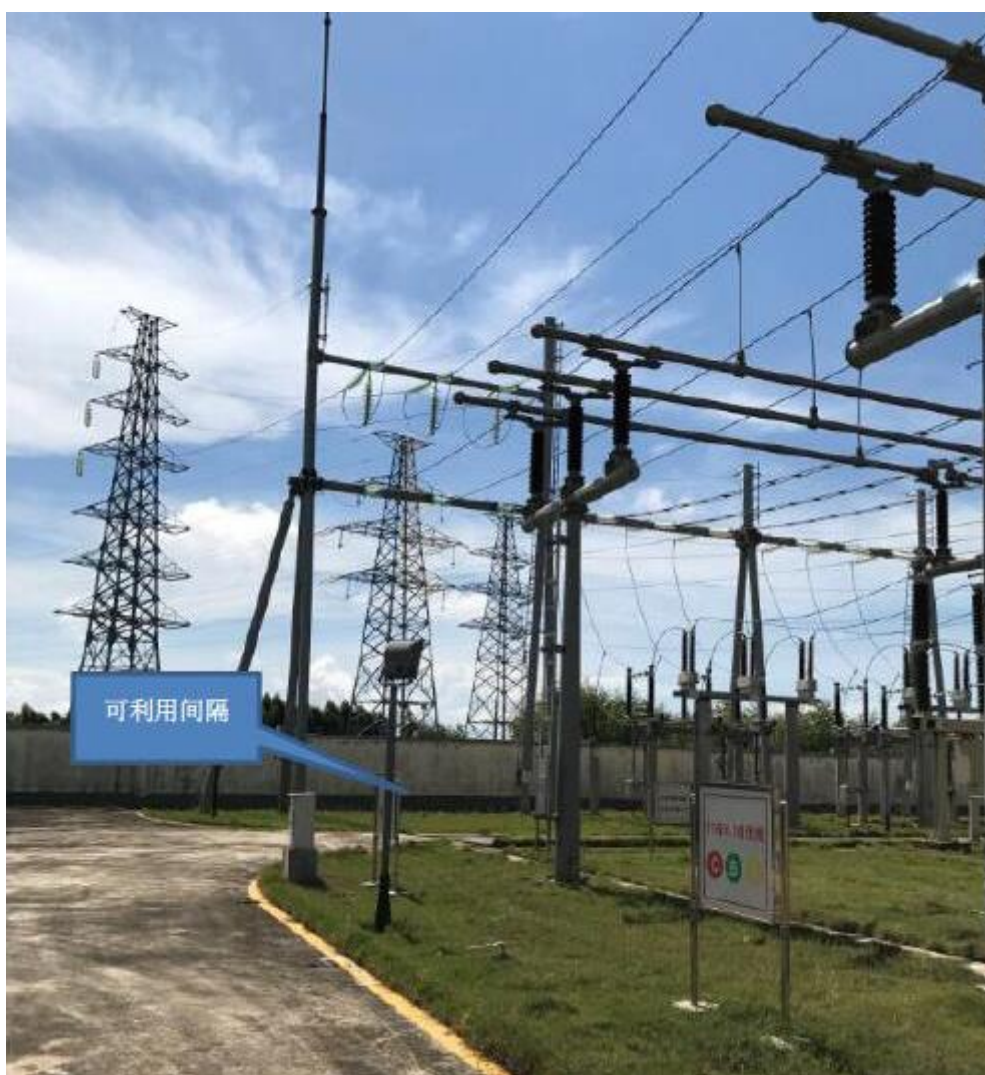
图 1 220kV 迈旺站现场情况
